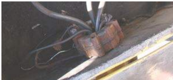
Рисунок 1. Проводник БКЗЖ не подключен к вспомогательной жиле кабеля 6 кВ. Заземляющая и вспомогательная жилы кабеля 6 кВ подключены под один зажим.
