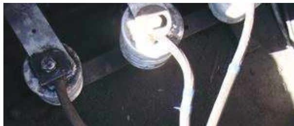
Рисунок 2. Жилы силового кабеля не оконцованы наконечниками
