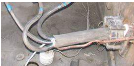
Рисунок 3. В условиях прохождения кабеля через окно ТНП, заземляющая жила от места разделки до заземляющего зажима не проходит через ТНП, что нарушает принцип действия токовой защиты нулевой последовательности
