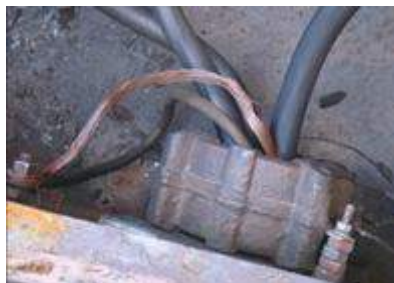
Рисунок 4. В условиях не прохождения кабеля через окно ТНП, заземляющая жила от места разделки до заземляющего зажима проходит через ТНП, что нарушает принцип действия токовой защиты нулевой последовательности
